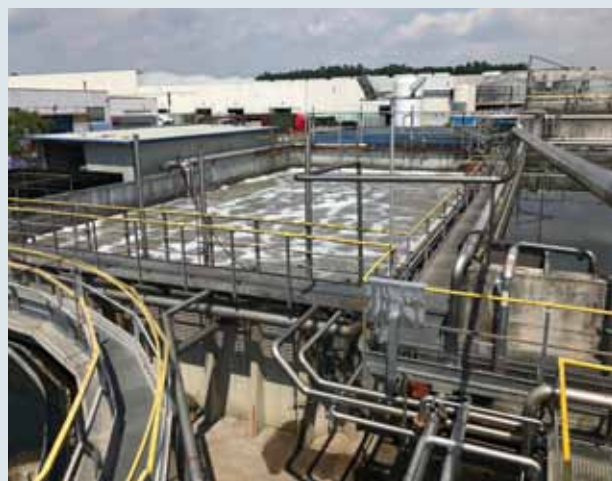
Impianto di depurazione per abbattimento del COD
