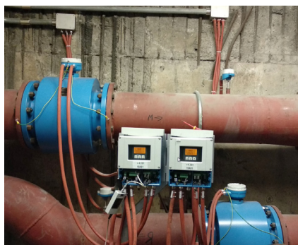
Misuratori di portata e sensori di temperatura installati
